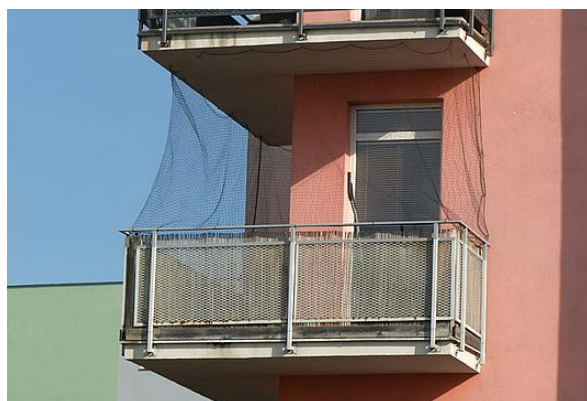
Obr. 30-34: Zábrany proti hnízdění jirůček.
